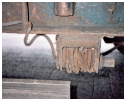
Ablegereife wegen starker Korrosion
